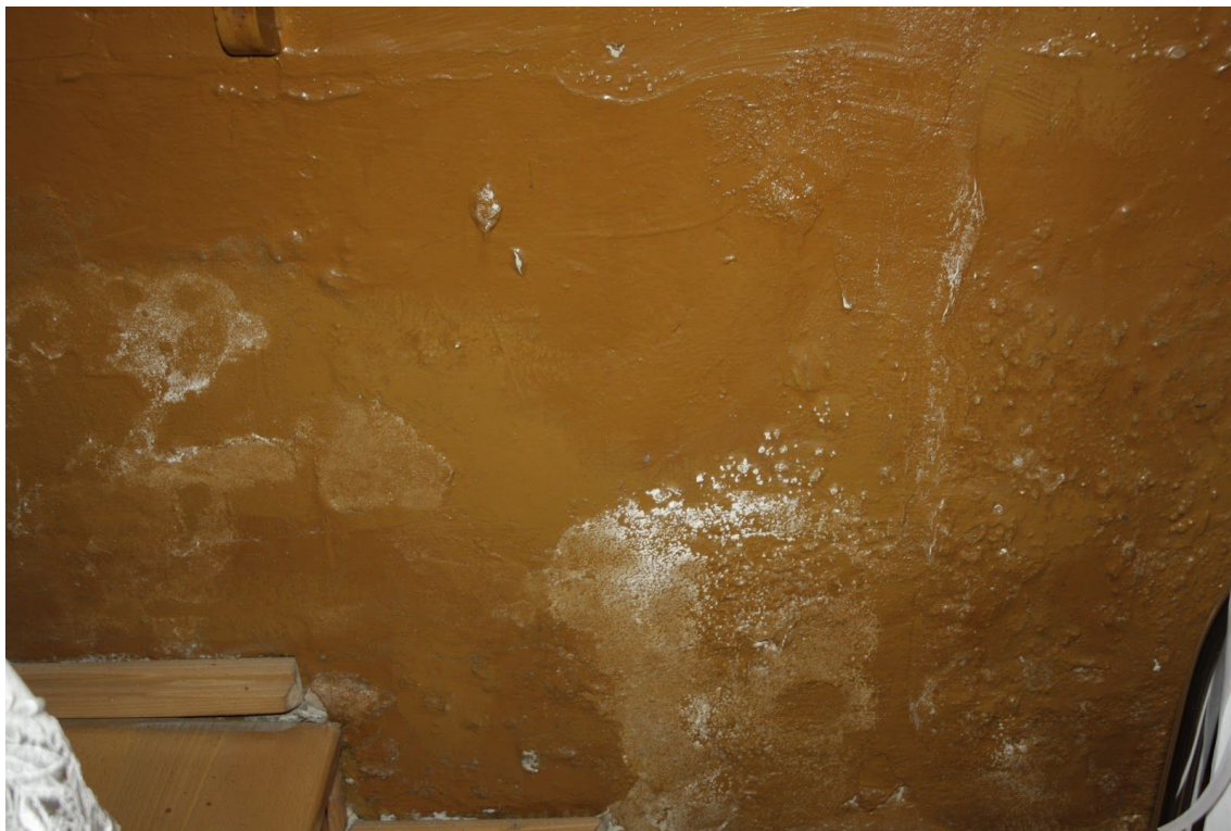
Fot. 17. Kościół p.w. św. Małgorzaty, dziewicy i męczennicy w Górze Świętej Małgorzaty. Bazy pilastrów, ściana południowa. Widoczne wykwity soli na lamperii olejnej. Fot. M. Kwiatkowski, 2021 r.
