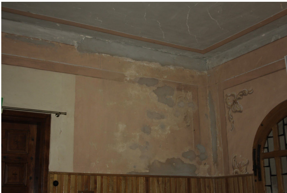
Fot. 28. Kościół p.w. św. Małgorzaty, dziewicy i męczennicy w Górze Świętej Małgorzaty. Kruchta. Widoczne przekucia, łaty cementowe. Fot. M. Kwiatkowski, 2021 r.
