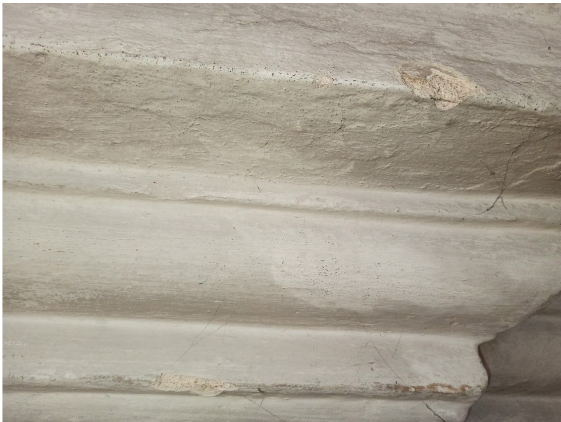
Fot. 23. Kościół p.w. św. Małgorzaty, dziewicy i męczennicy w Górze Świętej Małgorzaty. Ściana zachodnia, kapitel pilastra. Widoczne ubytki tynku. Fot. M. Kwiatkowski, 2021 r.
