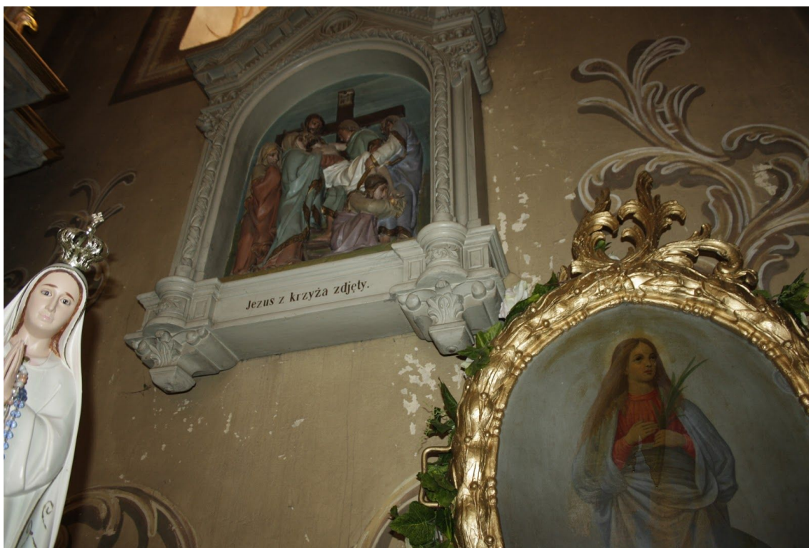
Fot. 18. Kościół p.w. św. Małgorzaty, dziewicy i męczennicy w Górze Świętej Małgorzaty. Ściana południowa, pierwsze przesło. Widoczna łuszcząca się warstwa malarska. Fot. M. Kwiatkowski, 2021 r.
