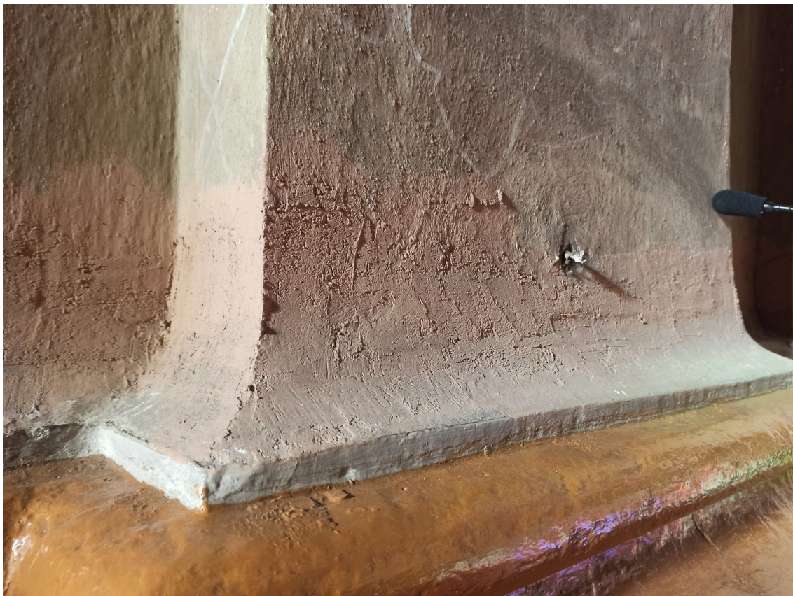
Fot. 19. Kościół p.w. św. Małgorzaty, dziewicy i męczennicy w Górze Świętej Małgorzaty. Ściana południowa, pilastry. Widoczne łąty cementowe, łuszcząca się warstwa malarska. Fot. M. Kwiatkowski, 2021 r.
