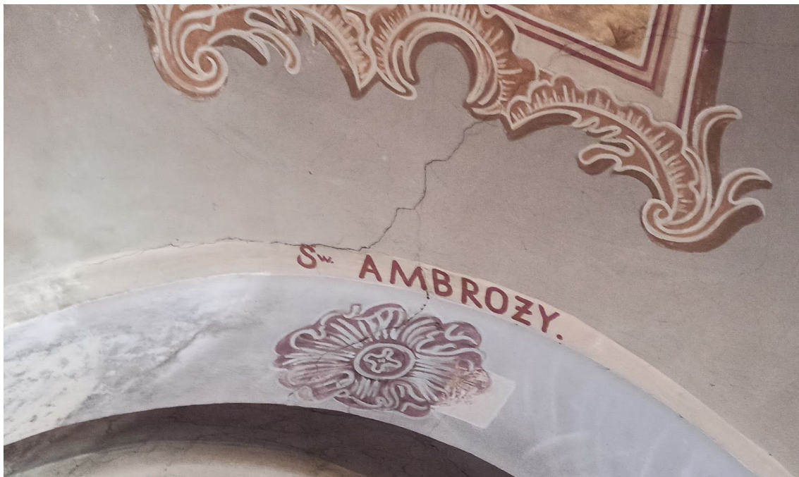
Fot. 21. Kościół p.w. św. Małgorzaty, dziewicy i męczennicy w Górze Świętej Małgorzaty. Ściana południowa, łuk nad otworem okiennym. Widoczne pęknięcia tynku.
