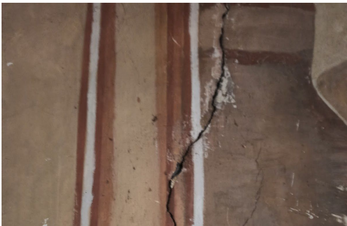
Fot. 22. Kościół p.w. św. Małgorzaty, dziewicy i męczennicy w Górze Świętej Małgorzaty. Ściana południowa. Widoczne pęknięcia tynku.
