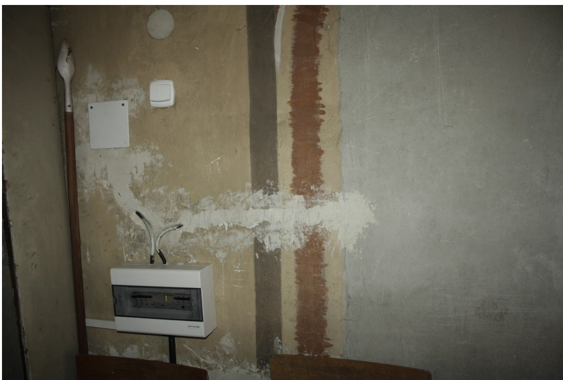
Fot. 20. Kościół p.w. św. Małgorzaty, dziewicy i męczennicy w Górze Świętej Małgorzaty. Ściana chóru. Widoczne łąty gipsowe, łuszcząca się warstwa malarska. Fot. M. Kwiatkowski, 2021 r.
