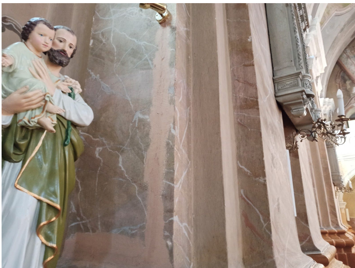
Fot. 24. Kościół p.w. św. Małgorzaty, dziewicy i męczennicy w Górze Świętej Małgorzaty. Ściana południowa, pilastry. Widoczne przekucia elektryczne. Fot. M. Kwiatkowski, 2021 r.
